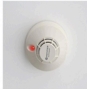
Hệ thống đầu báo khi có sự cố cháy
