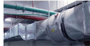
Hệ thống hút khí thải
