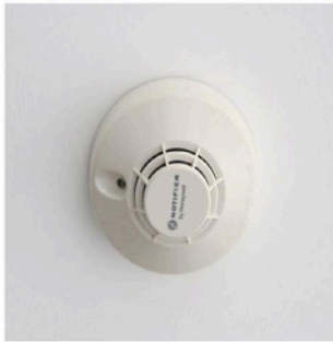
Hệ thống đầu báo ở trạng thái bình thường
