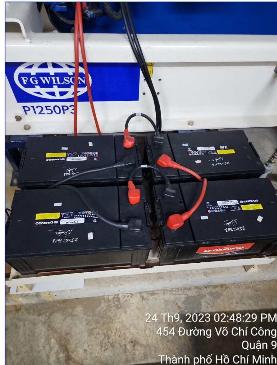
CÔNG TÁC ĐỊNH KỲ - KIỂM TRA BÌNH ẮC QUY MÁY PHÁT ĐIỆN
