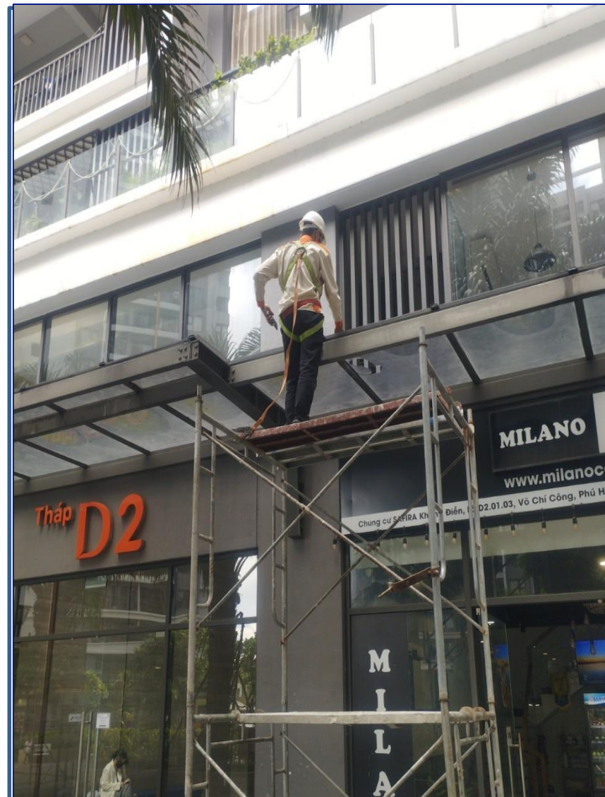
CÔNG TÁC SỬA CHỮA - GIÁM SÁT THAY MÁI ĐÓN CANOPY BỊ VỠ
