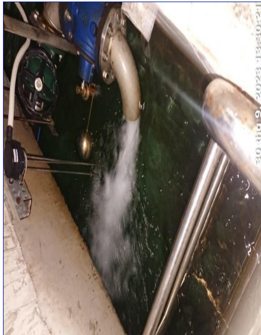
CÔNG TÁC ĐỊNH KỲ - KIỂM TRA BỂ BƠM SINH HOẠT
