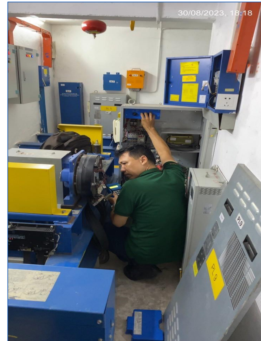
CÔNG TÁC GIÁM SÁT - NGÀY 25/08/2023 NHÀ THẦU KIỂM TRA THANG MÁY LỖI
