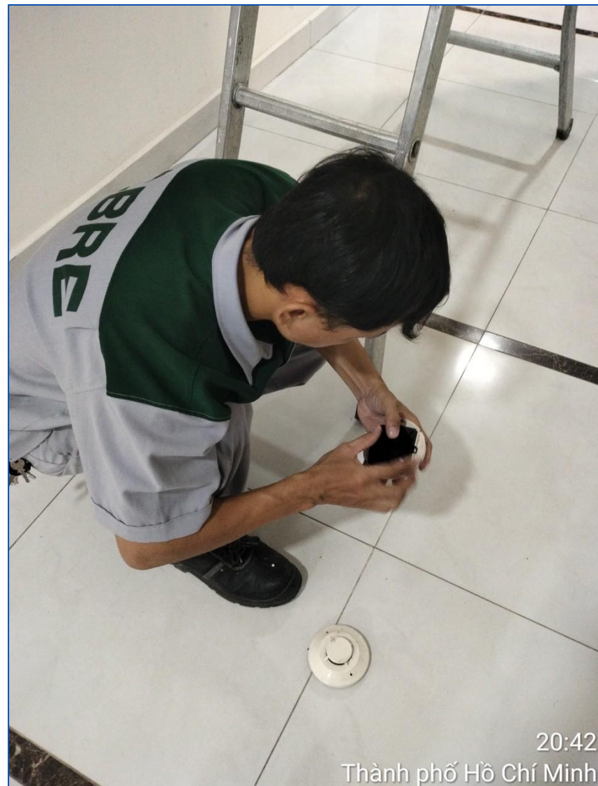
BẢO TRÌ. BẢO DƯỠNG - NGÀY 25/08/2023 ĐẦU BÁO CHÁY HÀNH LANG TẦNG
