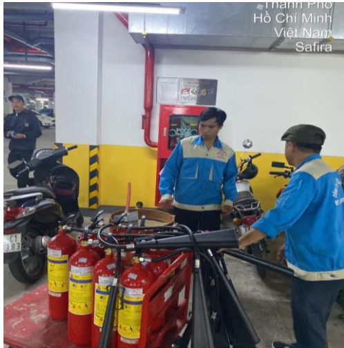
CÔNG TÁC ĐỊNH KỲ - 25/07/2023 GIÁM SÁT NHÀ THẦU BẢO DƯỠNG, NẠP SẠC BÌNH CHỮA CHÁY
