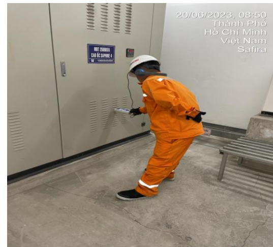
CÔNG TÁC ĐỊNH KÌ 20/06/2023 GIÁM SÁT ĐIỆN LỰC KIỂM TRA TRẠM BIẾN THÉ
