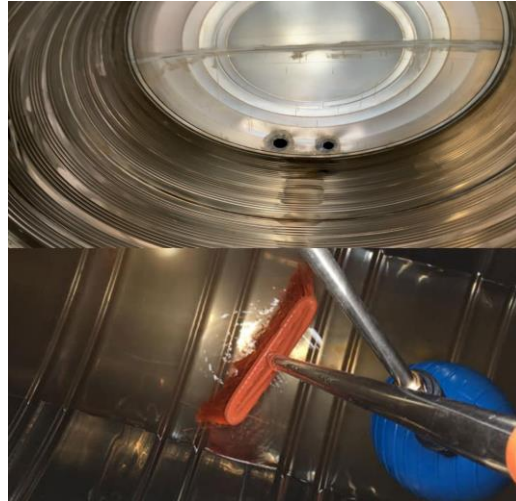
CÔNG TÁC ĐỊNH KỲ - 16/06/2023 VỆ SINH BỒN NƯỚC SINH HOẠT TẦNG MÁI
