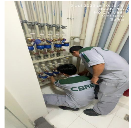
SỬA CHỮA NHỎ - 26/06/2023 KIỂM TRA VỆ SINH ĐỒNG HỒ NƯỚC CĂN HỘ
