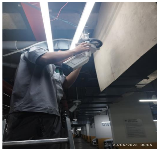
CÔNG TÁC KHẮC PHỤC- 20/06/2023 KIỂM TRA VÀ XỬ LÝ LỖI CAMERA LỖI VÀO
