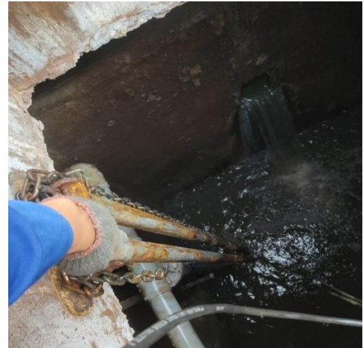
CÔNG TÁC ĐỊNH KỲ - HÀNG NGÀY GIÁM SÁT VẬN HÀNH, BẢO TRÌ HỆ THỐNG XỬ LÝ NƯỚC THẢI
