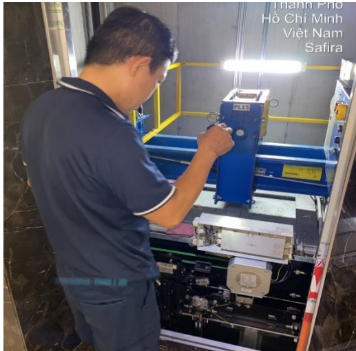
CÔNG TÁC ĐỊNH KỲ- 09/05/2023 PHỐI HỢP BẢO TRÌ THANG MÁY
