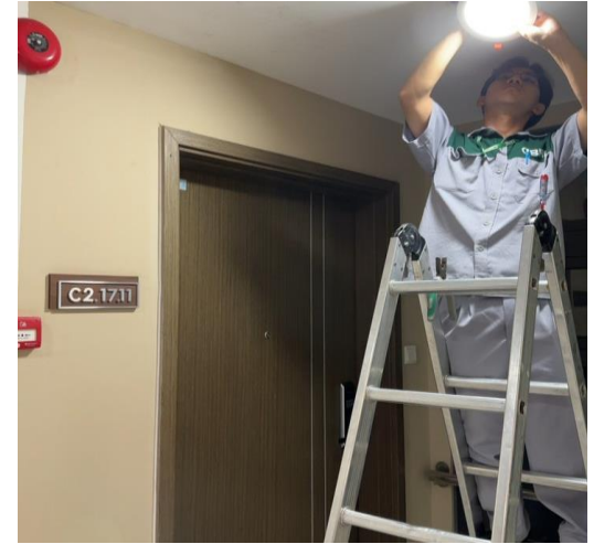
CÔNG TÁC ĐỊNH KỲ - 19/05/2023 THAY THẾ ĐÈN HÀNH LANG CÁC TẦNG - TÒA NHÀ
