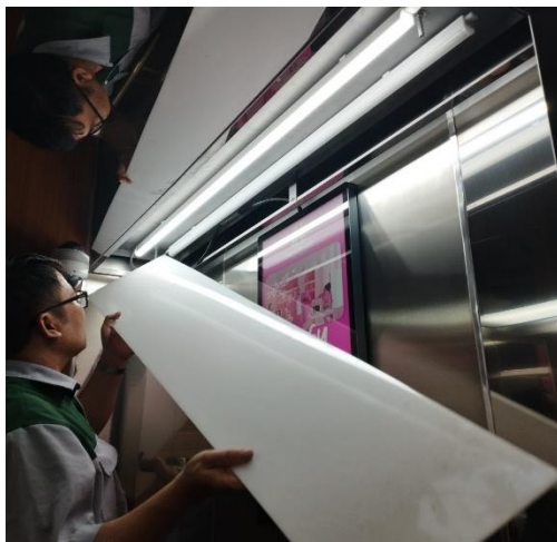
CÔNG TÁC KHẮC PHỤC- 22/05/2023 KIỂM TRA VÀ XỬ LÝ LỖI THANG MÁY
