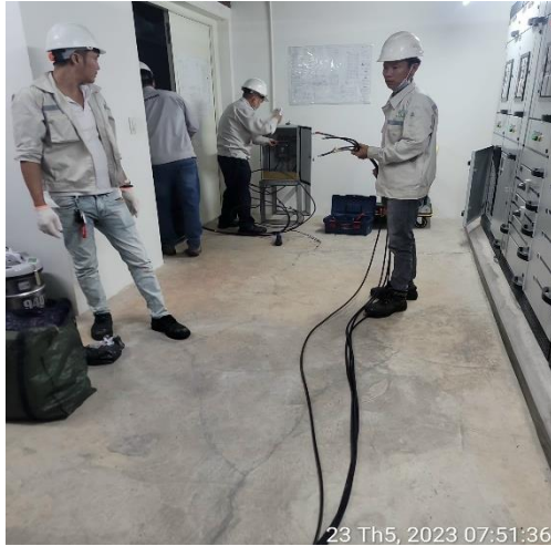
CÔNG TÁC ĐỊNH KỲ - 23/05/2023 PHỐI HỢP BẢO TRÌ HỆ THỐNG ĐIỆN MSB
