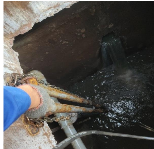
CÔNG TÁC ĐỊNH KỲ - 22/05/2023 GIÁM SÁT VẬN HÀNH, BẢO TRÌ HỆ THỐNG XỬ LÝ NƯỚC THẢI
