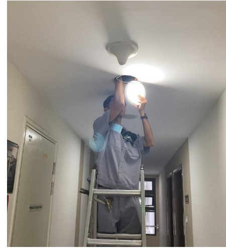
CÔNG TÁC ĐỊNH KỲ - 19/04/2023 THAY THẾ BÓNG ĐÈN HÀNH LANG TẦNG TÒA NHÀ
