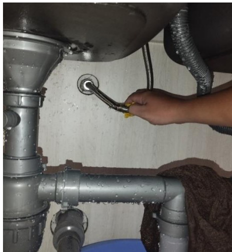
XỬ LÝ SỰ CỐ - 16/04/2023 TRẦN NƯỚC TỪ CĂN HỘ RA HÀNG LANG
