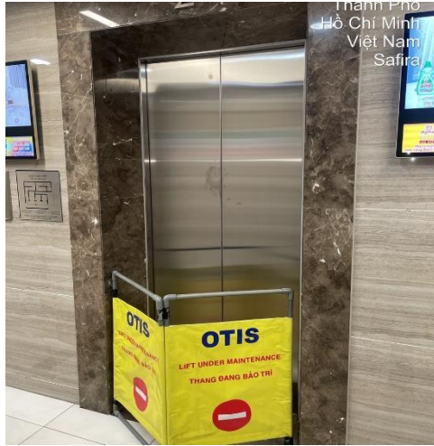
CÔNG TÁC ĐỊNH KỲ - 21/04/2023 PHỐI HỢP BẢO TRÌ THANG MÁY
